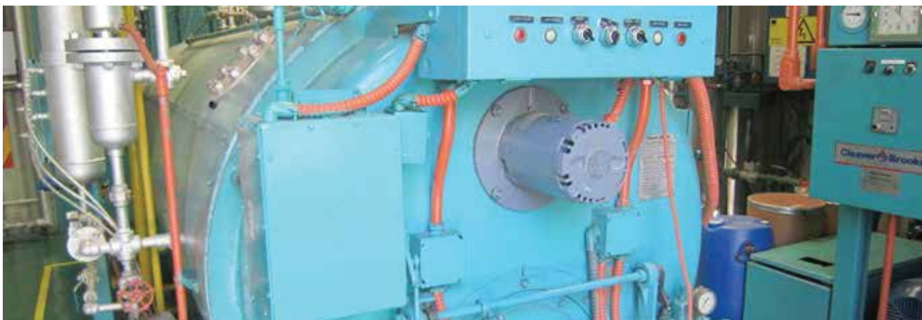
Caldera con cables de control con armadura de tipo Interlock (en color naranja).
